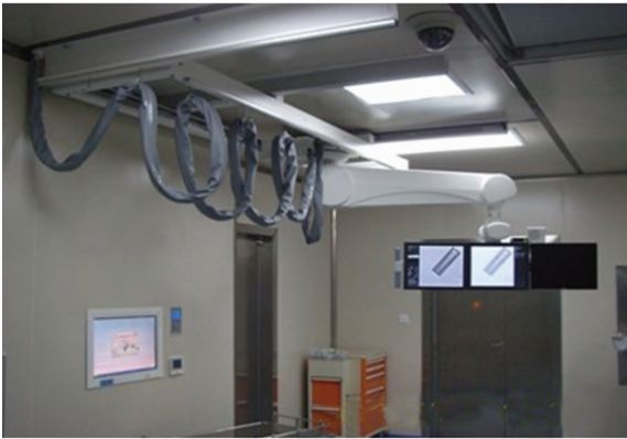
图 1 手术室内移动显示系统
